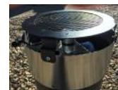
Solar Vent Fan
